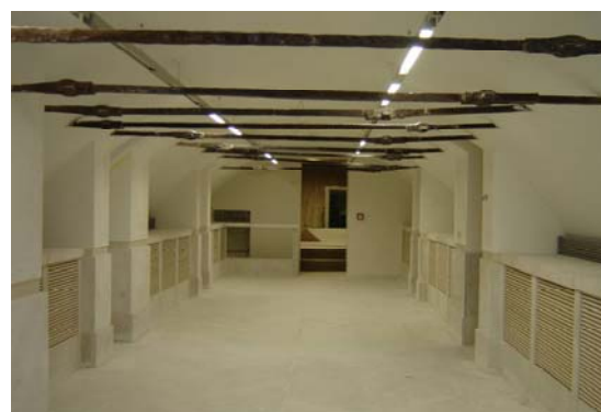
Sala de Barras
